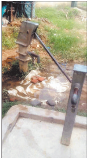
सोलर पैंल के खराब होने पर सूखा पड़ा नलकूप।
